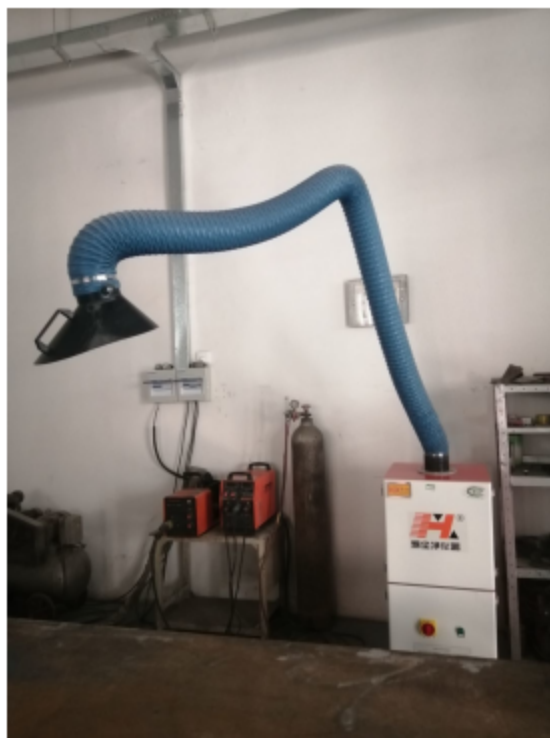
图 3-4 切割、焊接工序废气处理设施照片
