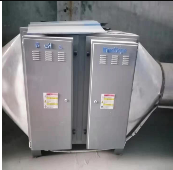
UV光氧设备+过滤棉吸附装置
