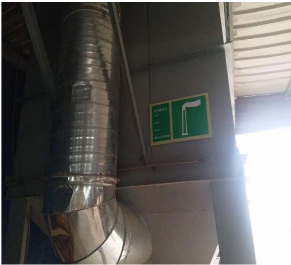
排气筒标示牌
