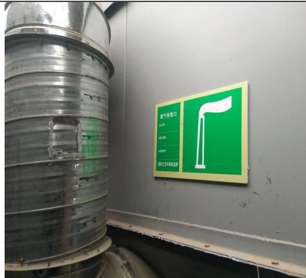
排气筒标示牌
