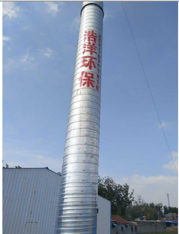
排气筒及采样口
